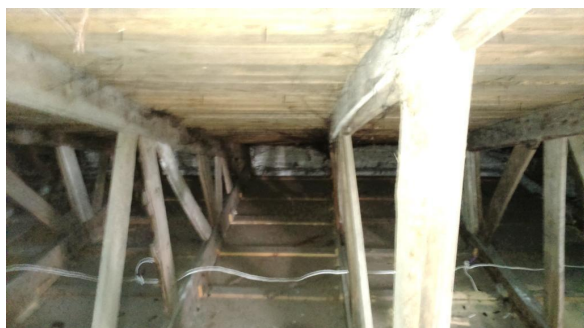
1. Widocznie skręcone, zwichrzone elementy kratownic drewnianych
