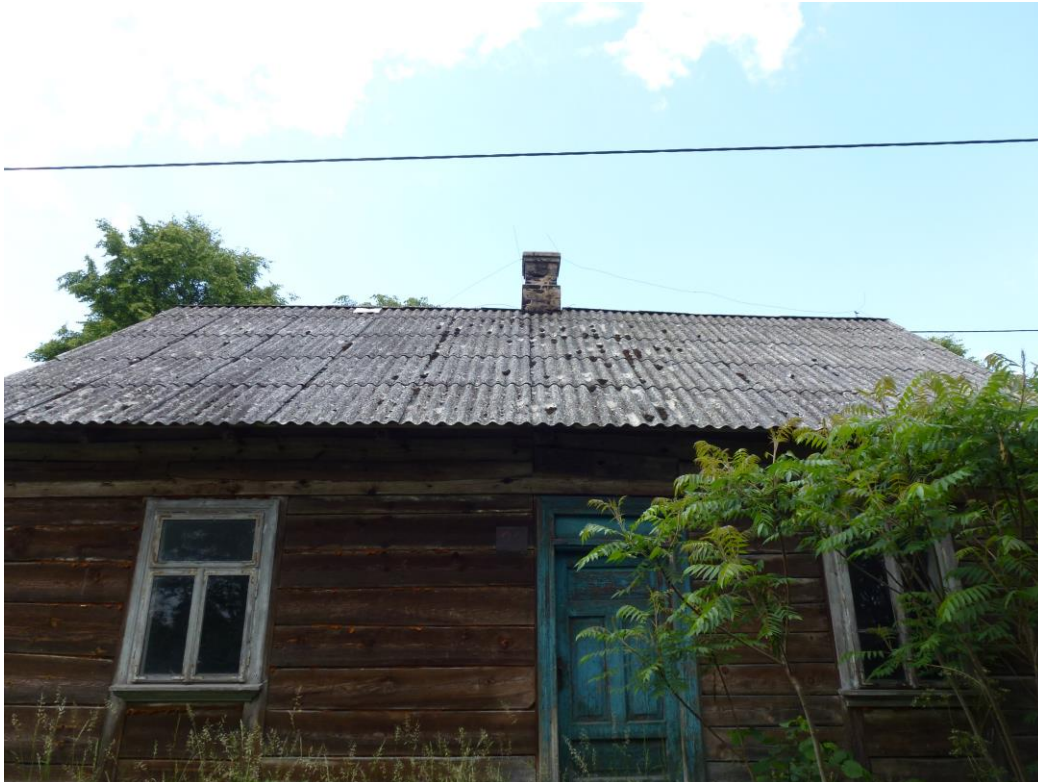
Rys. 9. Budynek pokryty azbestem falistym (Źródło: Fotografia własna)
